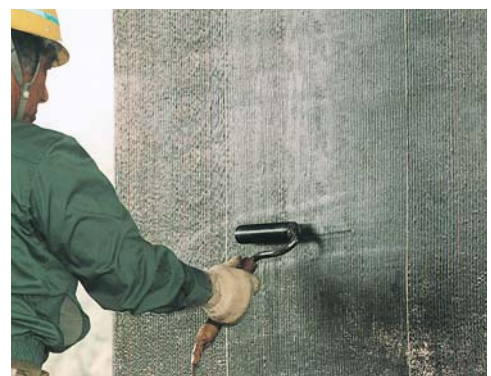
アイロンローラーによる樹脂含浸施工状況 (アイロンを使用した樹脂含浸方法は、弊社の特許です。)
