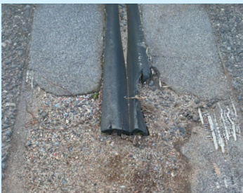
▲ 既設ゴムの変状例
