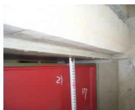
躯体と鉄骨との隙間
