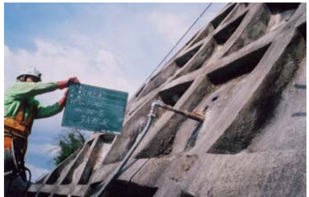
▲吹付けのり枠
